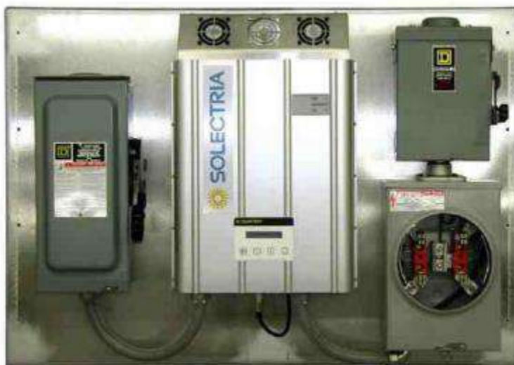
Fig. 8. Invertor Solectria, pe un panou de alimentare precablat
